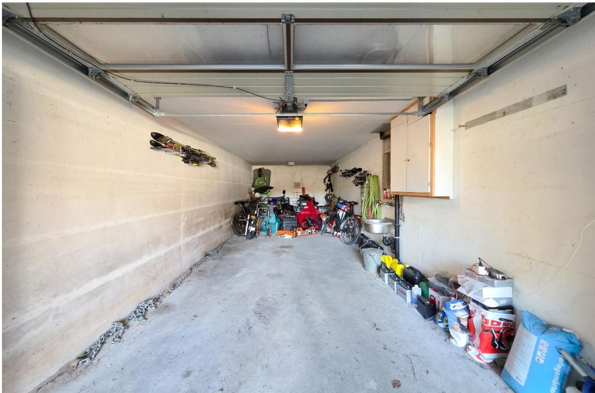
Die grosszügige Garage mit der Elektroverteilung
