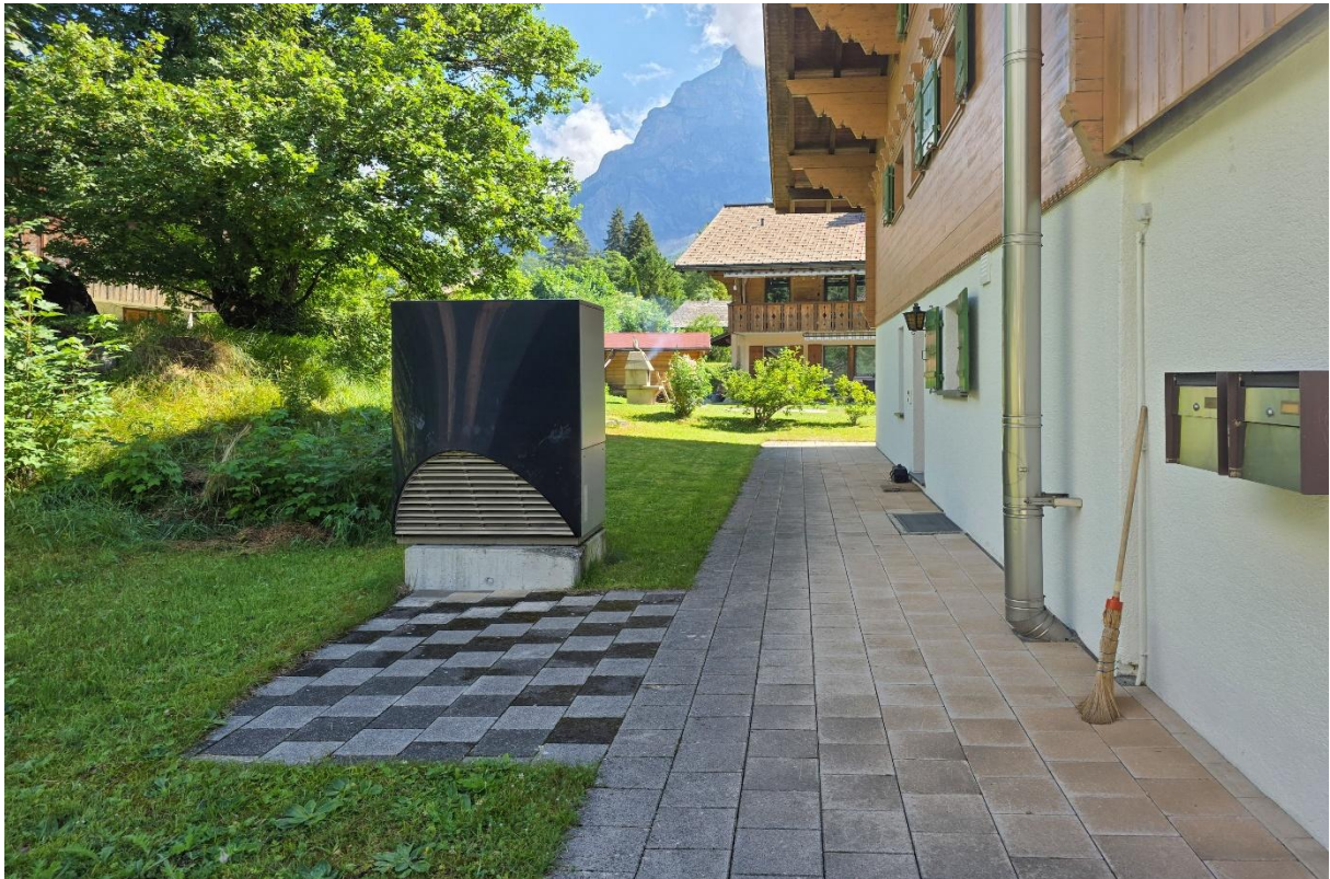
...der Luft- und Wärmepumpe
