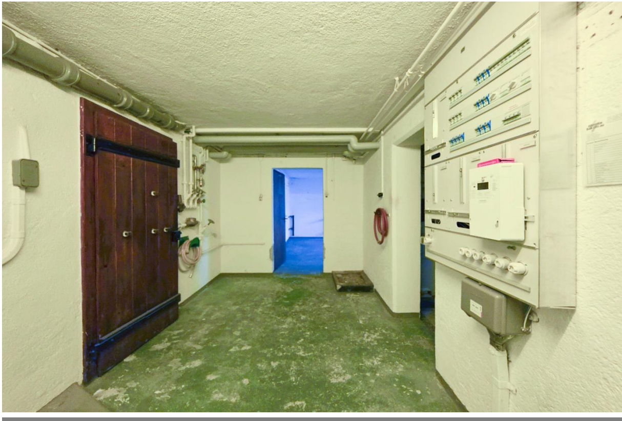
Der Korridor zu den Kellerräumlichkeiten mit Elektrotabelleu
