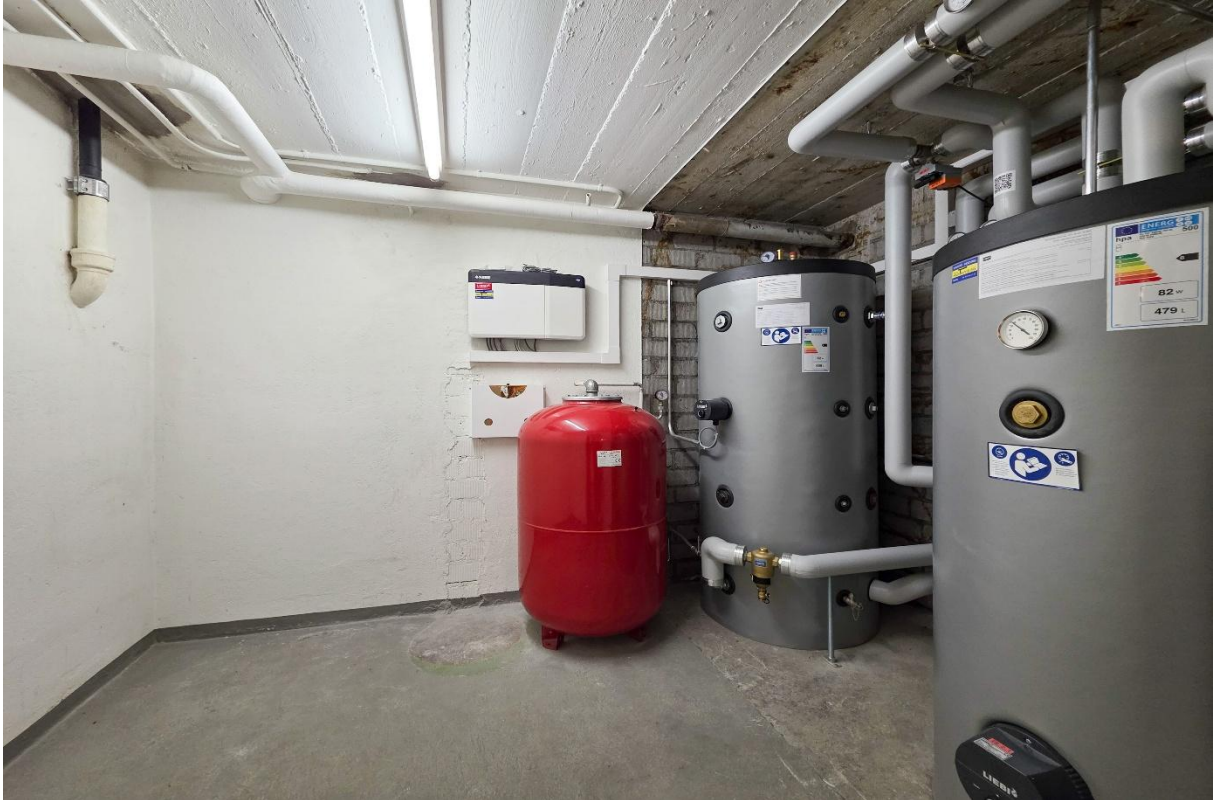
Kellerraum 5 - der Technikraum mit der Heizung und den Boilern
