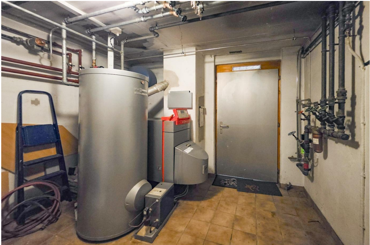
Der Technik- Heizraum. Nebenan befindet sich die Waschküche
