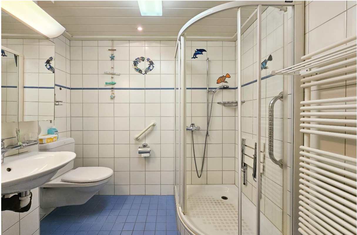
Das Badezimmer mit Dusche, Toilette, Handwaschbecken und Handtuchradiator
