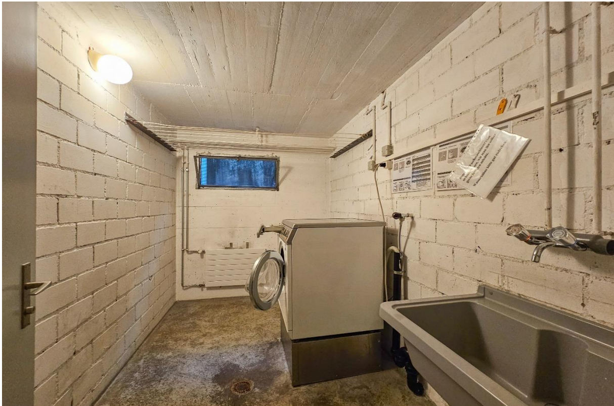
Es stehen zwei Waschküchen mit Waschmaschine und Handwaschbecken zur Verfügung
