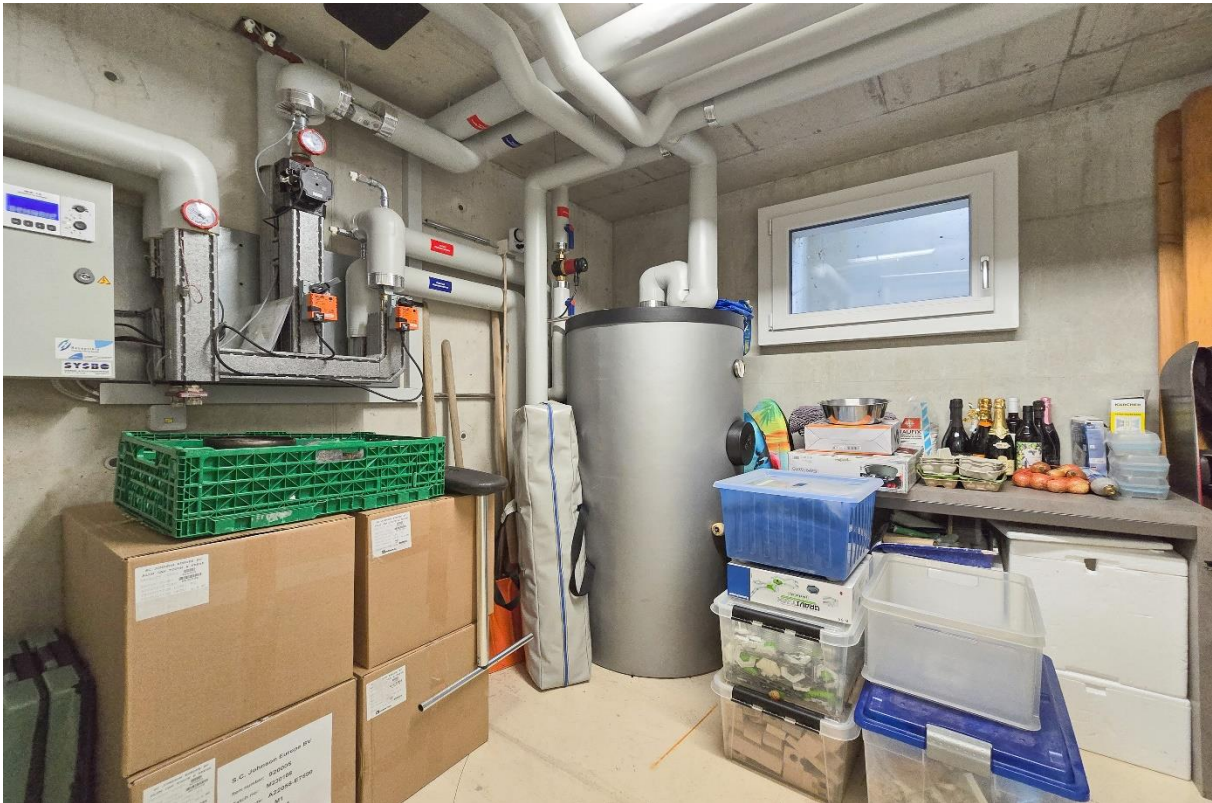
Der Technikraum mit der haustechnischen Anlage und weiteren Stauraum
