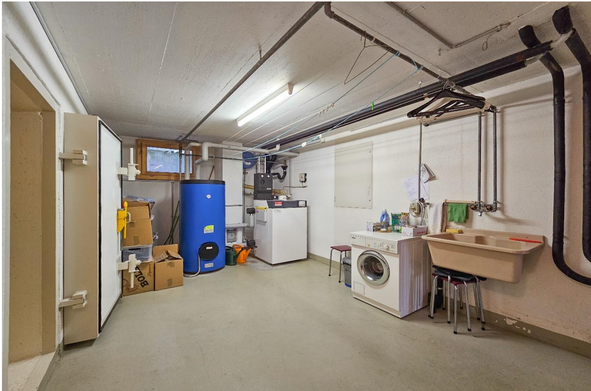
Der Technikraum mit Heizung, Boiler und Waschmaschine
