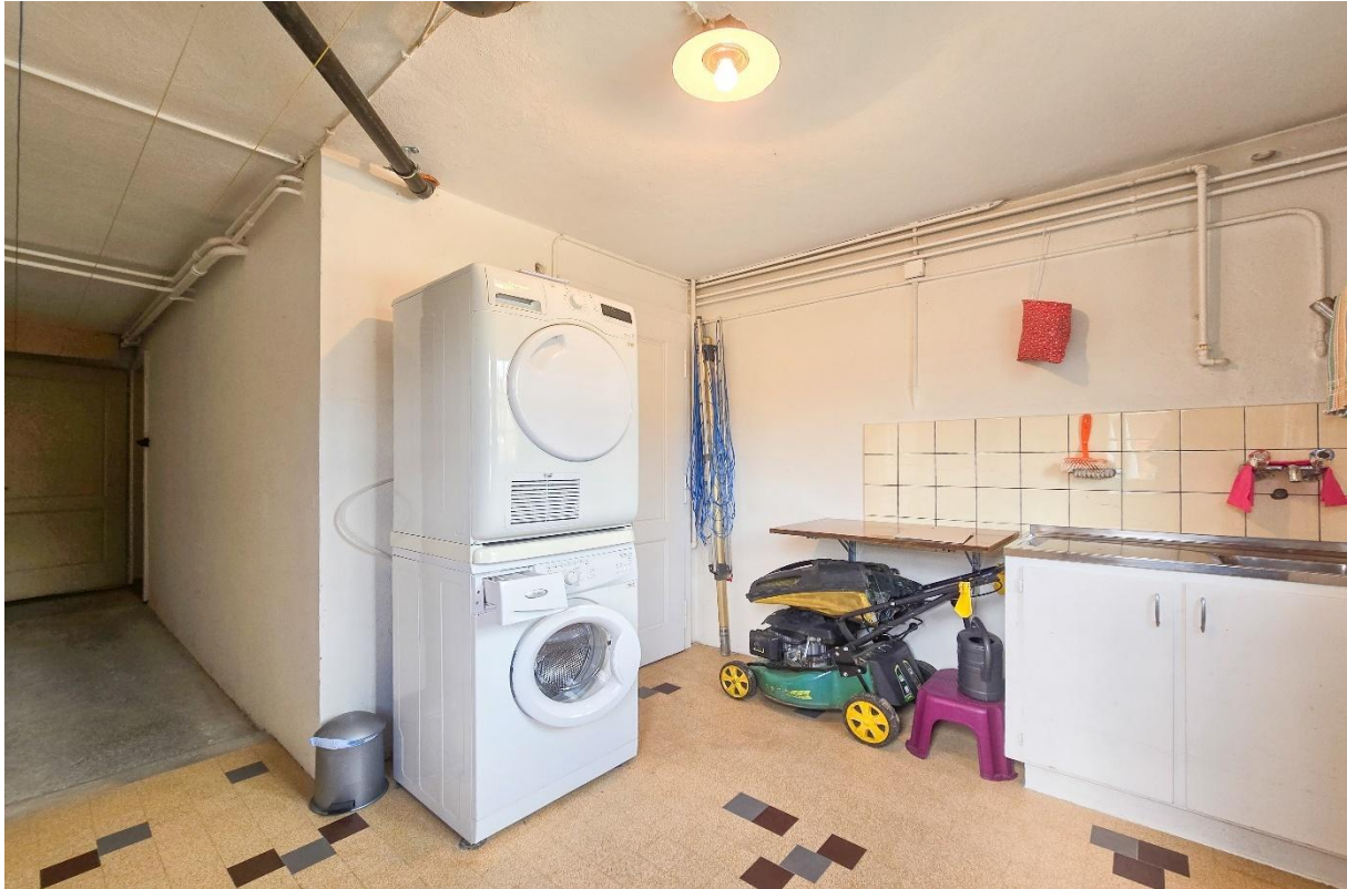
Der Technikraum/Waschküche mit Wäscheturm und Handwaschbecken
